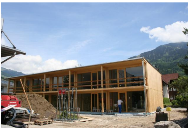
der Rohbau wurde in 5 Tagen aufgebaut der Innenausbau wurde von TransitarbeiterInnen unter fachlicher Anleitung ausgeführt
